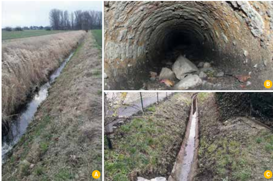
Menschliche Überprägung von Gewässern – Begradigter Verlauf am Hohen Graben (A), Blick in einen verrohrten Abschnitt des Breitenfelder Mittelgrabens mit groben Schuttablagerungen (B), stark eingegängtes und in Beton-elementen geführtes Gewässerprofil am Sommerfelder Graben (C)
